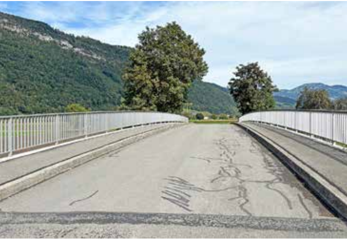
Die Brücke ist in schadhaftem Zustand.
