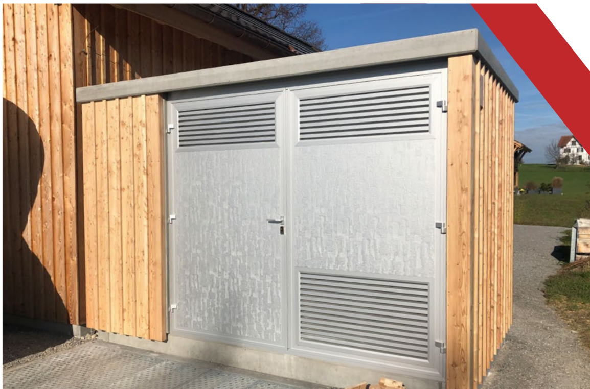
Neue Trafostation Schnart
