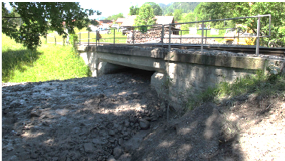
Abbildung 14 BLS-Brücke Abfluss 2016 Blick von unten ohne Einsatz Baumaschinen wäre BLS-Linie überströmt worden
