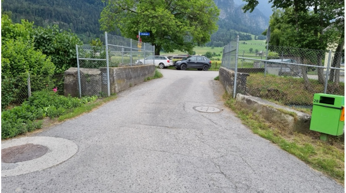
Abbildung 4: bestehende, zu schmale Brücke über den Mühlbach
