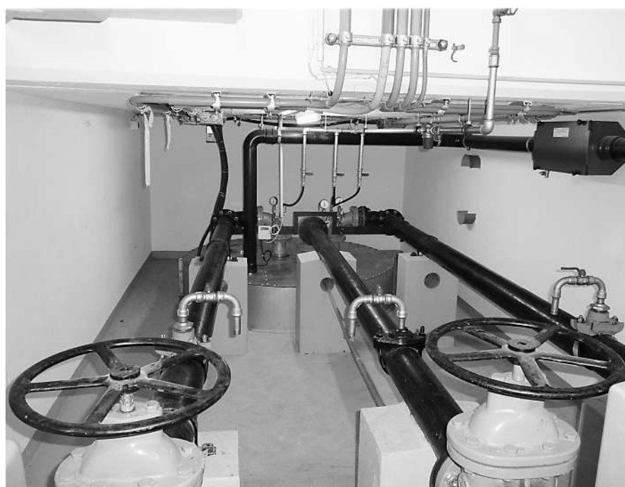
Installationen im Grundwasserpumpwerk Bürgerfeld.
