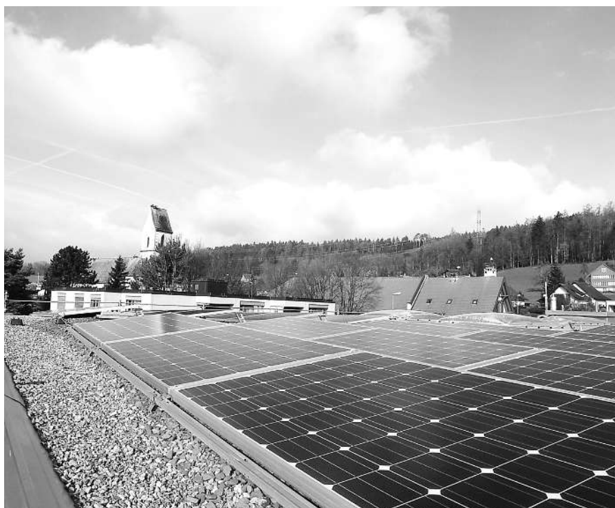
Auf dem Dach der neuen Bibliothek wird eine Solaranlage betrieben.
