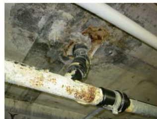
undichter Ablauf vom Beckenumgang
