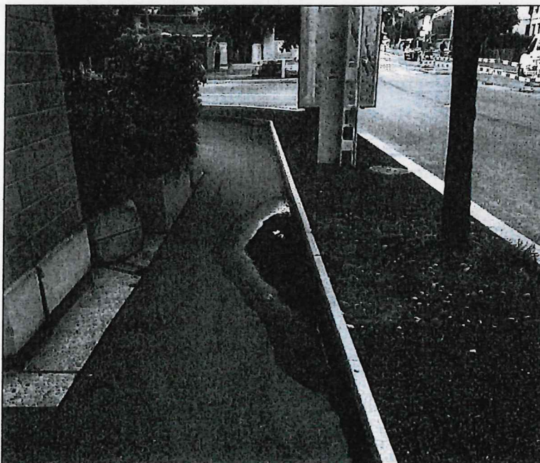
Figure 9: Largeur du trottoir devant la Treille a un minimum de 1m16, largeur pas conforme aux prescriptions. Cette observation sera reprise, si cela n'est pas corrigé, par la COGEST 2024. De plus, le revêtement n'est pas idéalement horizontal !
