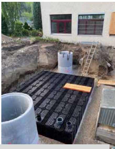
...Versickerungsanlage für Dachwasser
