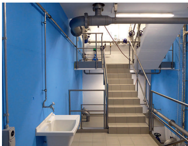
Innenansicht des neuen Reservoirs Rüti
