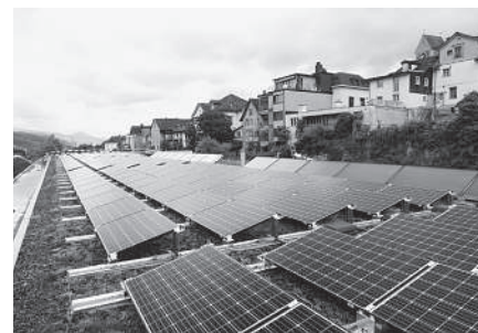
Strom und Wärme vom Dach des Altersheims
