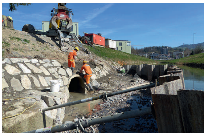
Einleitung des Meteorwassers in den Steinenbach
