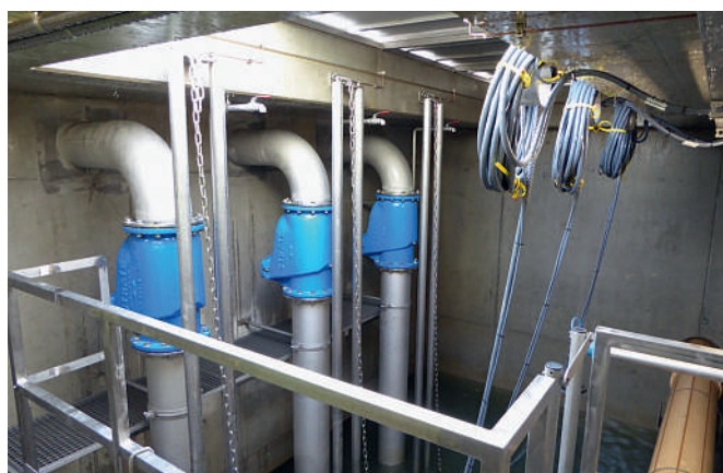
Bei erhöhtem Wasserstand des Steinenbachs befördern Pumpenleitungen das Wasser in den Ablauf
