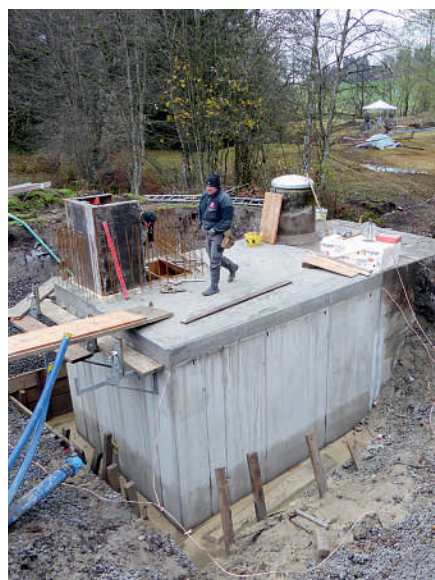
Neuer Trinkwasserpumpenschacht auf dem Ricken
