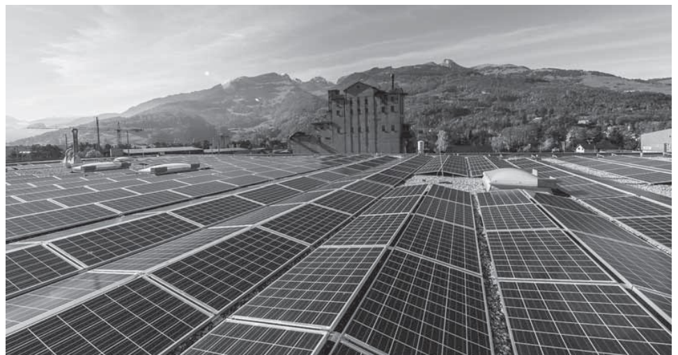
Photovoltaikanlage des EWB: Gewinnung von Solarstrom im Aufwärtstrend
