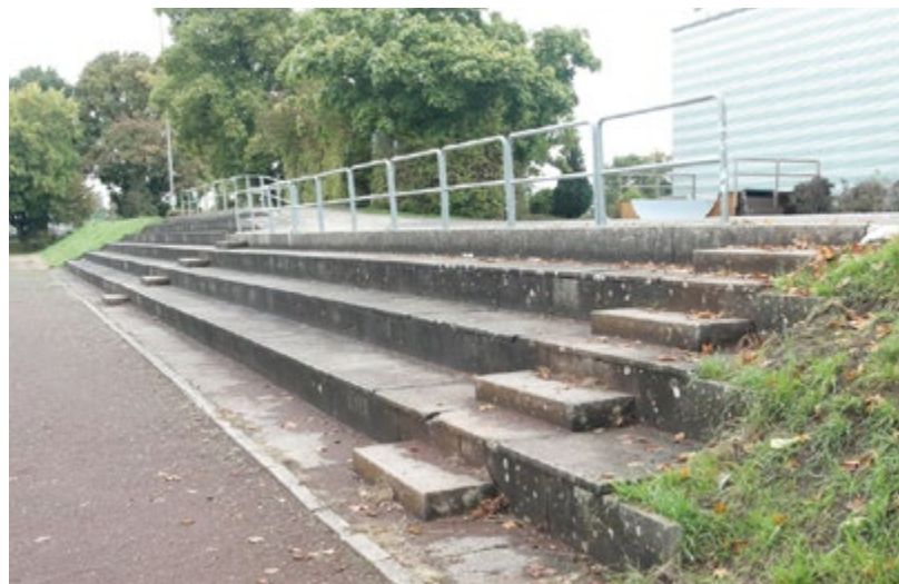
Grossen Sanierungsbedarf gibt es sowohl bei den Stehrampen als auch an der 400-Meter-Bahn auf der Grünau.
