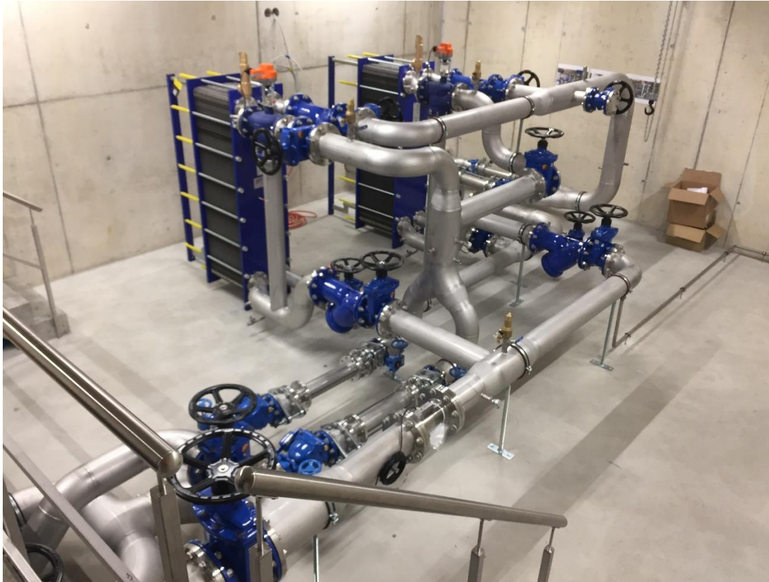
CENTRALE DE PRELEVEMENT DE CHALEUR, RESERVOIR DES PHILOSOPHES Echangeurs de chaleur à plaques en inox 2 x 500 kW
