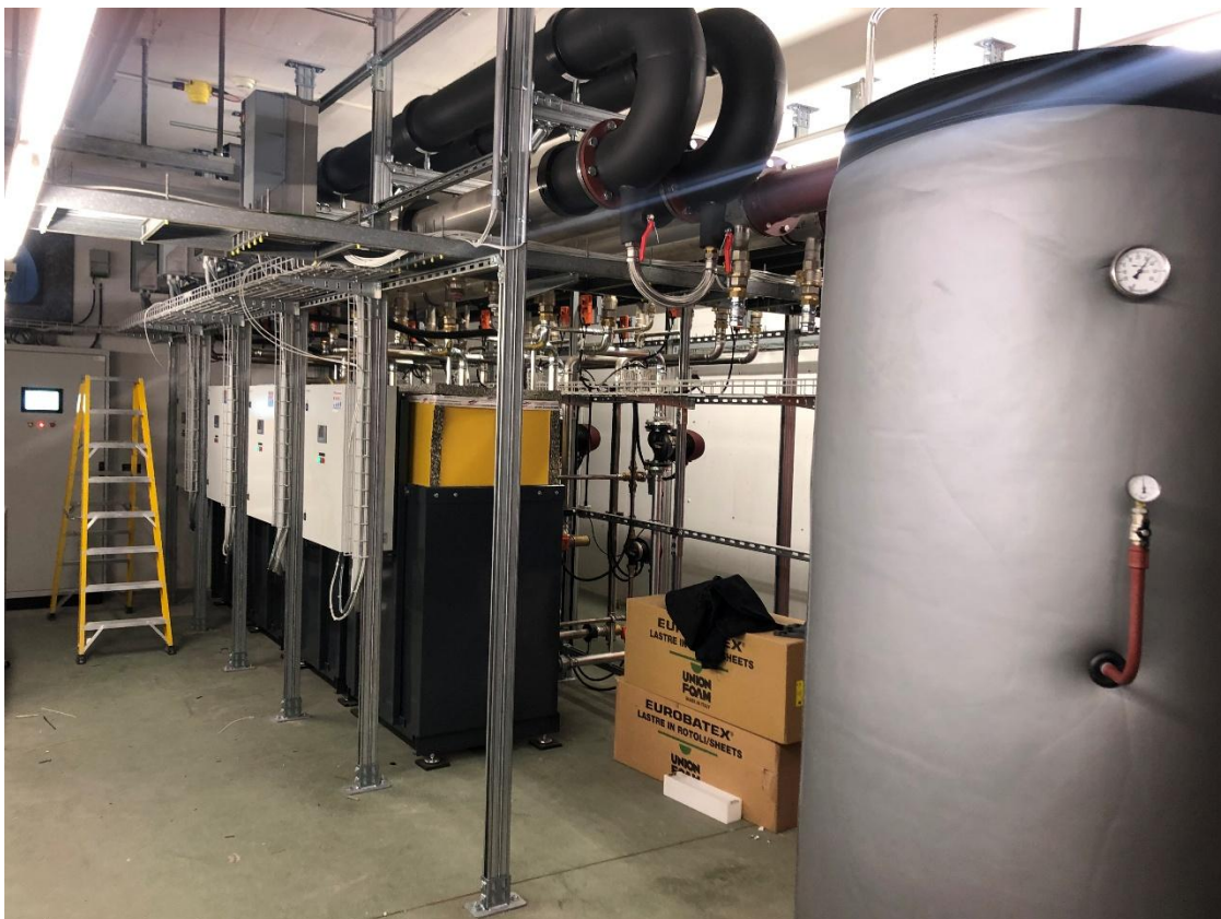
LES 4 POMPES A CHALEUR DE L'HÔPITAL (550 KW)
