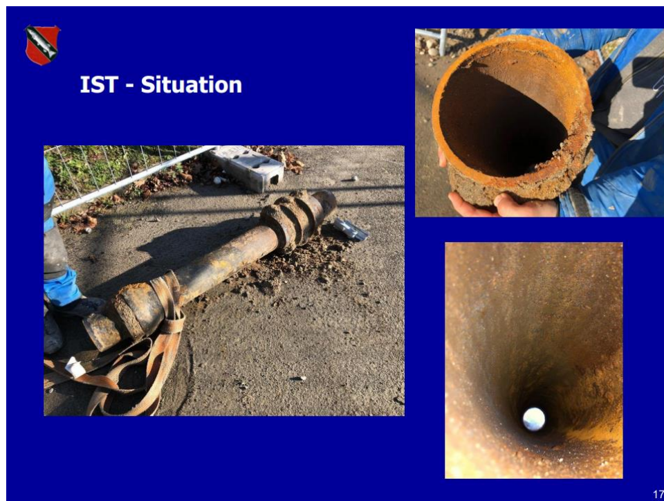
Folie 2 – Foto – Kupplungsstück eines Ersetzten Rohres & rostige Leitung 1+2
