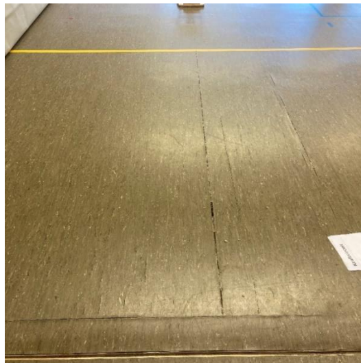
Foto mit Rissen im Boden
