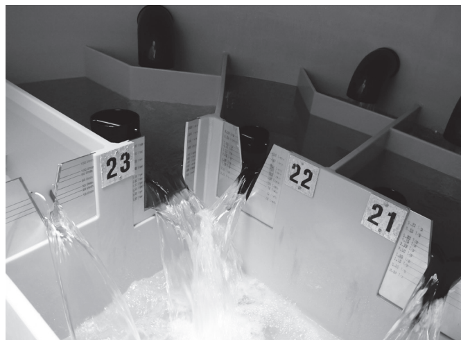
Zusammenführung Quellen in einer Brunnenstube
