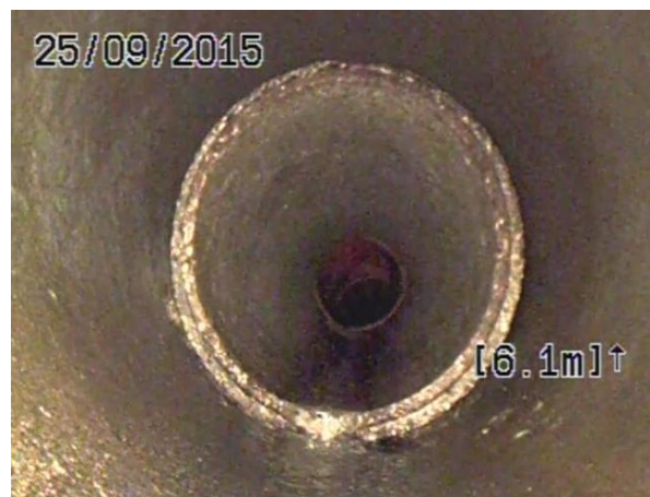
Changement de diamètre, décalage et joint non étanche
