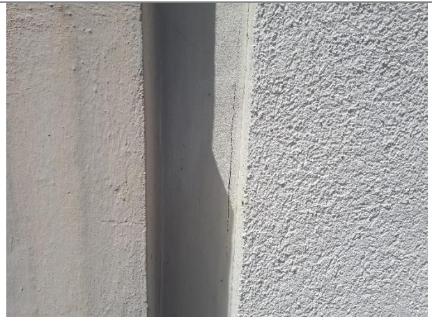
Süd; Riss in Fuge Turm-Kirche; auf ca. 1.5m Höhe 1mm breit und 40cm lang, weiter unten noch ein Riss ca. 20cm lang.
