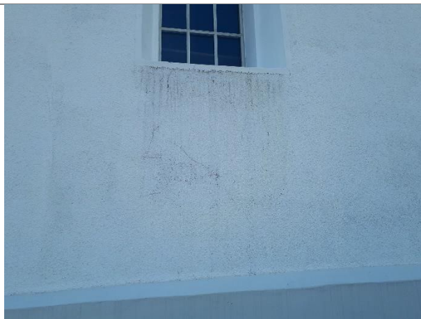
Ost; Feine Haarrisse in Brüstung und Sockel
