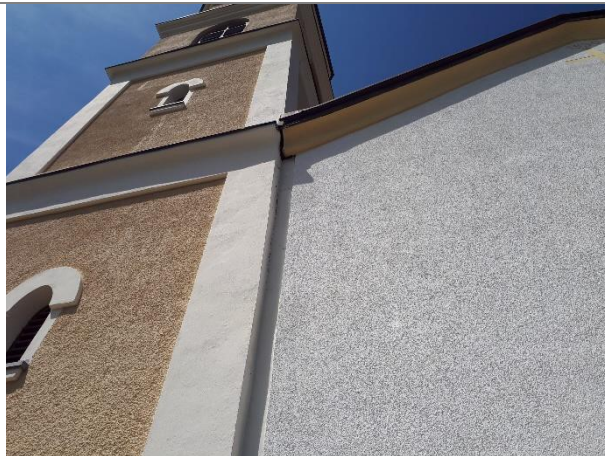
Süd; Turm-Kirche; Riss oben ca. 3m lang, mit Versatz (oben rechts von Fuge, dann über Fuge und noch etwas links von Fuge)
