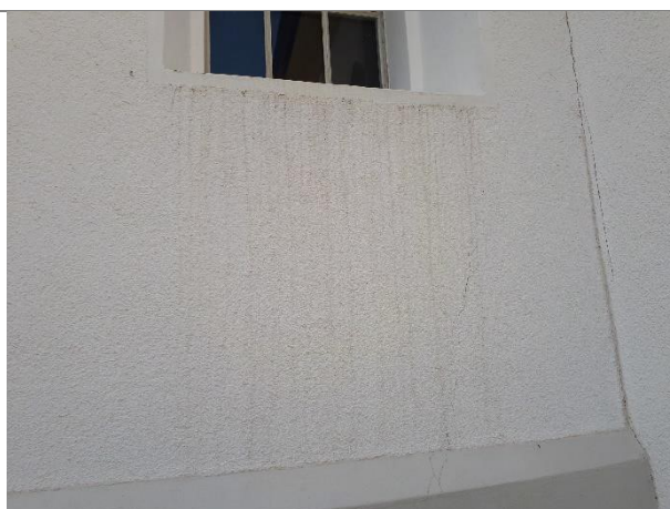
Ost; lokaler Riss unter Brüstung ca. 0.9mm
