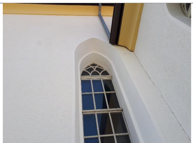
Ost; Kirche-Anbau; auf 1.5m höhe ca. 1.2mm, nach oben zunehmend.
