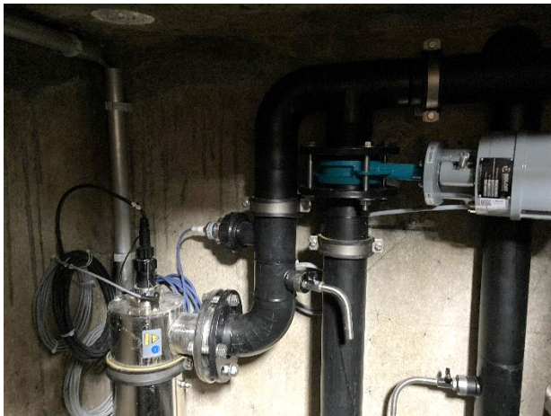
2020 eingebaute UV-Anlage mit Verwurf-Klappe
