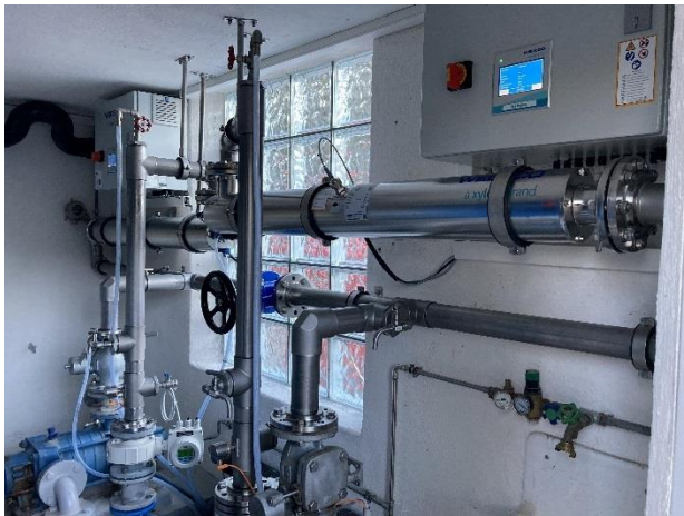
Quellwasserpumpen mit UV-Anlagen
