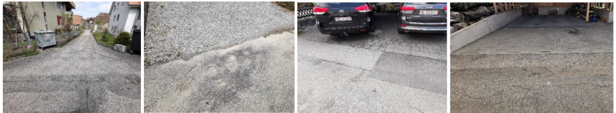
Abbildung 2: Allgemeiner Strassenzustand, polierte Flächen, Belagsflicke und Rissbildungen
