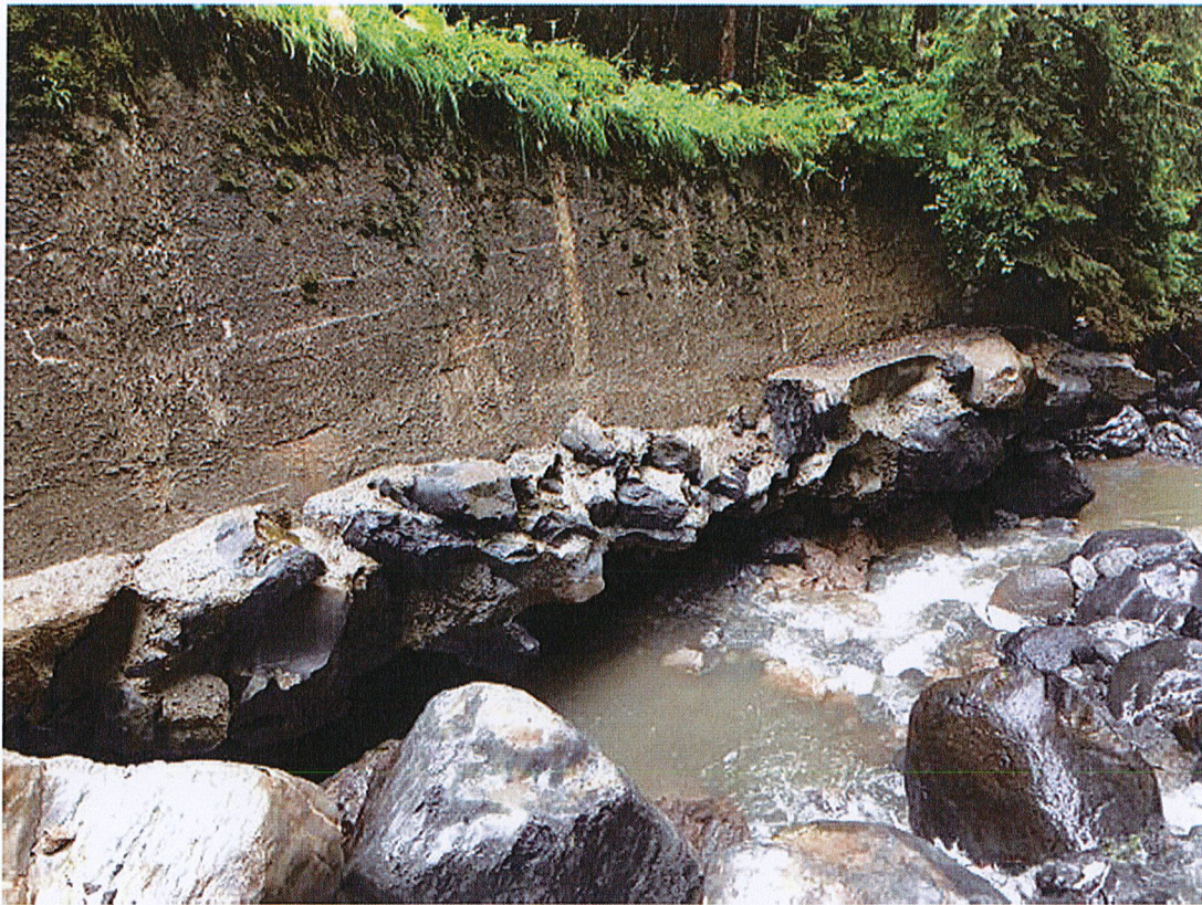
Mesure 2 : affouillement sous le mur de berge
