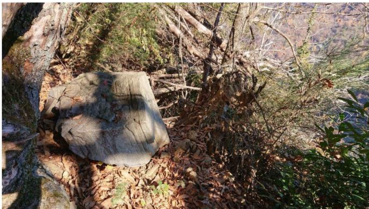
Figura 2: Esempio di sasso pericolante da demolire e sistemare in luogo sicuro
