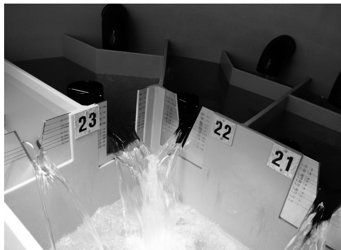
Zusammenführung Quellen in einer Brunnenstube
