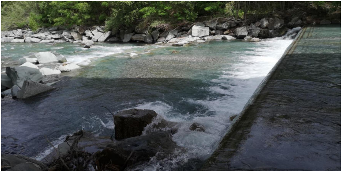
Abbildung 16: Schwelle Cumparduns, Sommer 2021: Kolkbildung und sichtbare Reste der 2016 zerstörten Blockrampe
